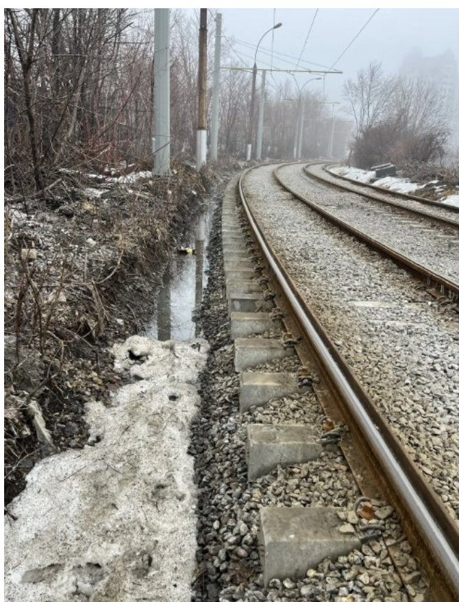
Рис.159. Подход к проспекту Победы со стороны остановочного пункта «Село Сырское». Подтопление балластного слоя трамвайного пути.
