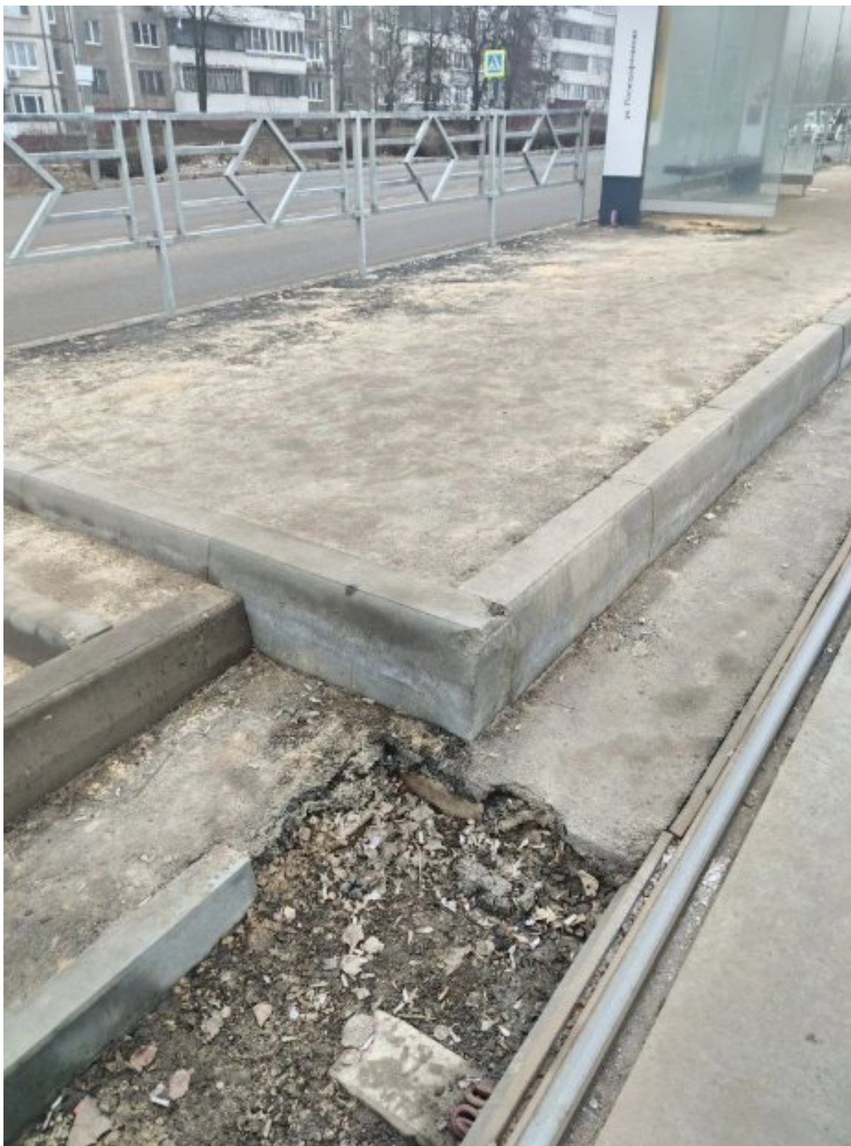
Рис. 100. Остановочный пункт «Улица Полиграфическая». Дефекты бортовых камней и асфальтового покрытия.
