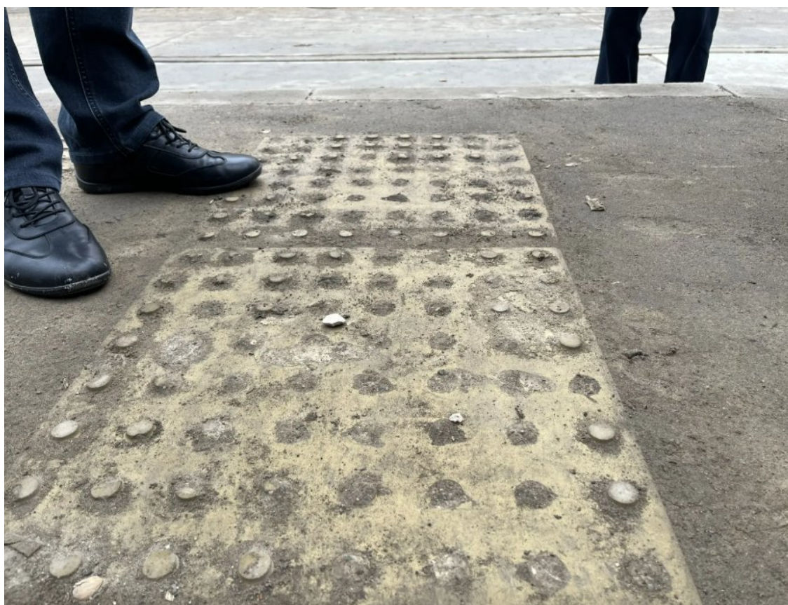
Рис. 38. Остановочный пункт «ЛТЗ» повреждение тактильной плитки.
