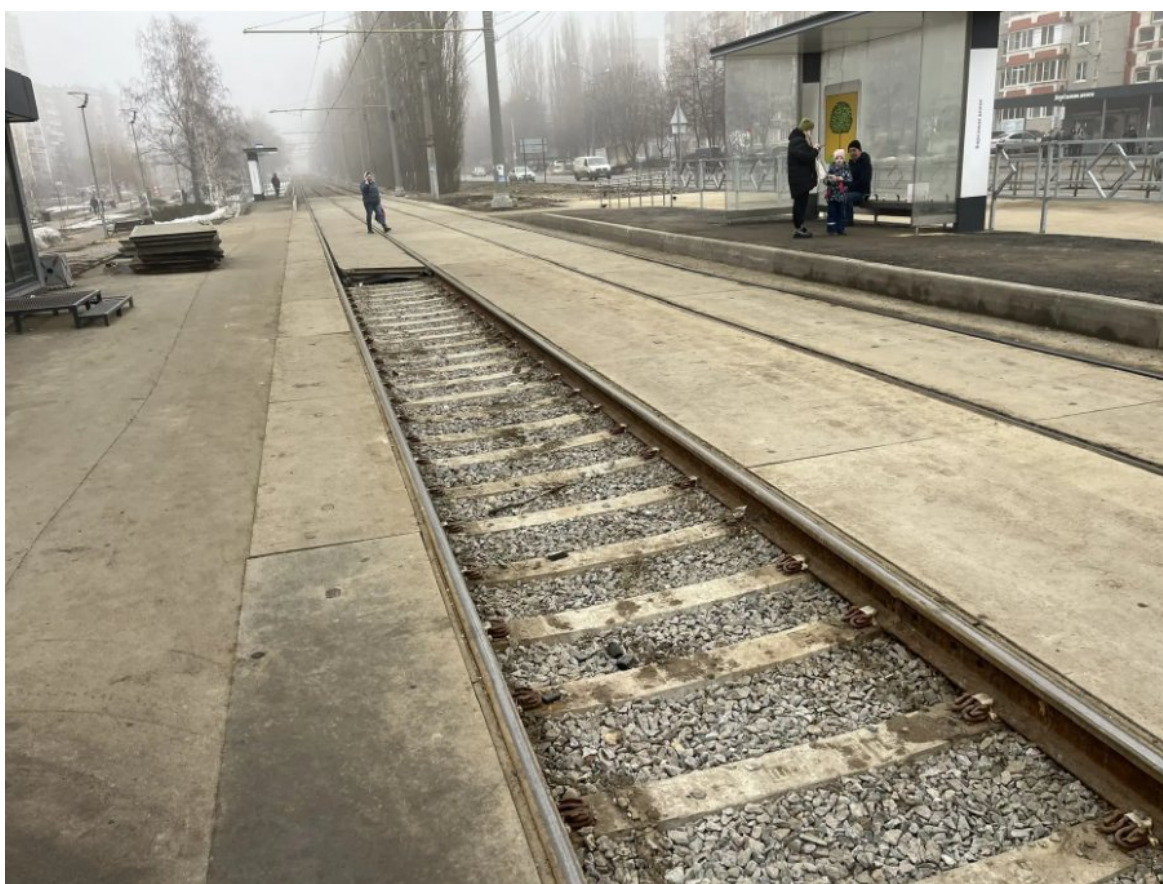
Рис. 78. Часть железобетонных плит в районе остановочного пункта «Березовая аллея» демонтирована в связи с подъёмом выше головки рельса.
