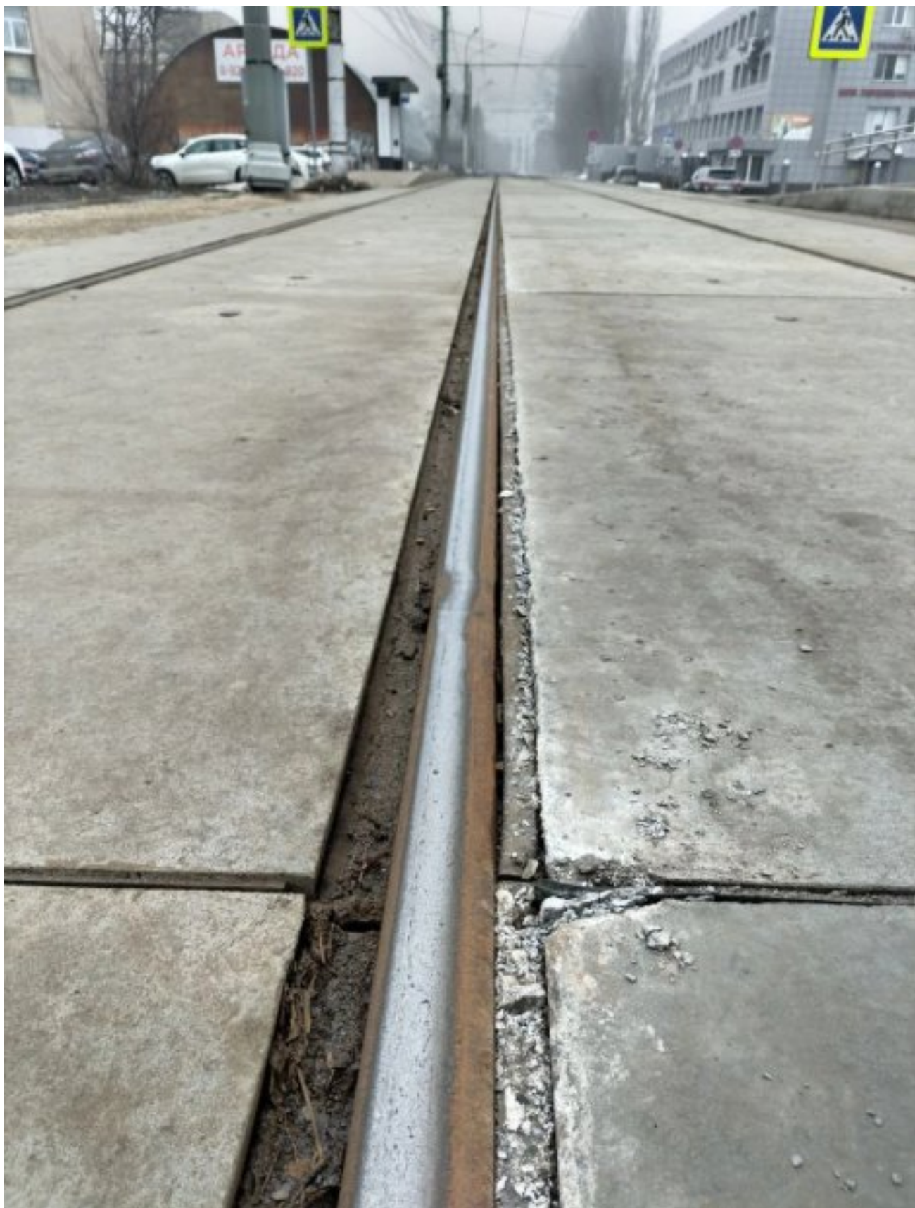
Рис. 106. Остановочный пункт «Полиграфический комплекс». Повреждение межпутевых плит.
