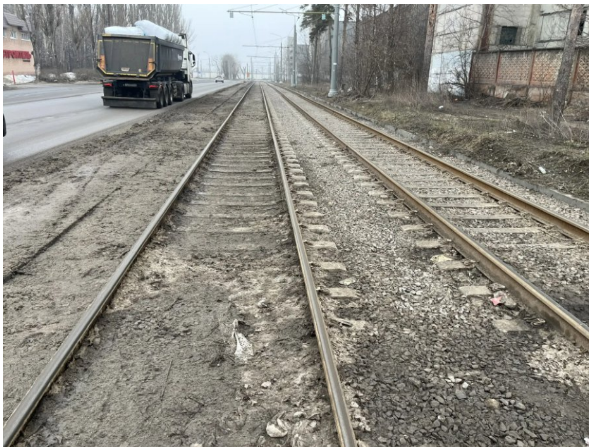
Рис. 43. Засорение балластного слоя открытого трамвайного пути по ул. Краснозаводская
