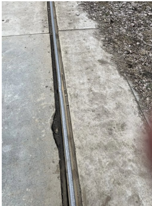
Рис. 63. Повреждение железобетонных плит в районе остановочного пункта «Улица Катукова».
