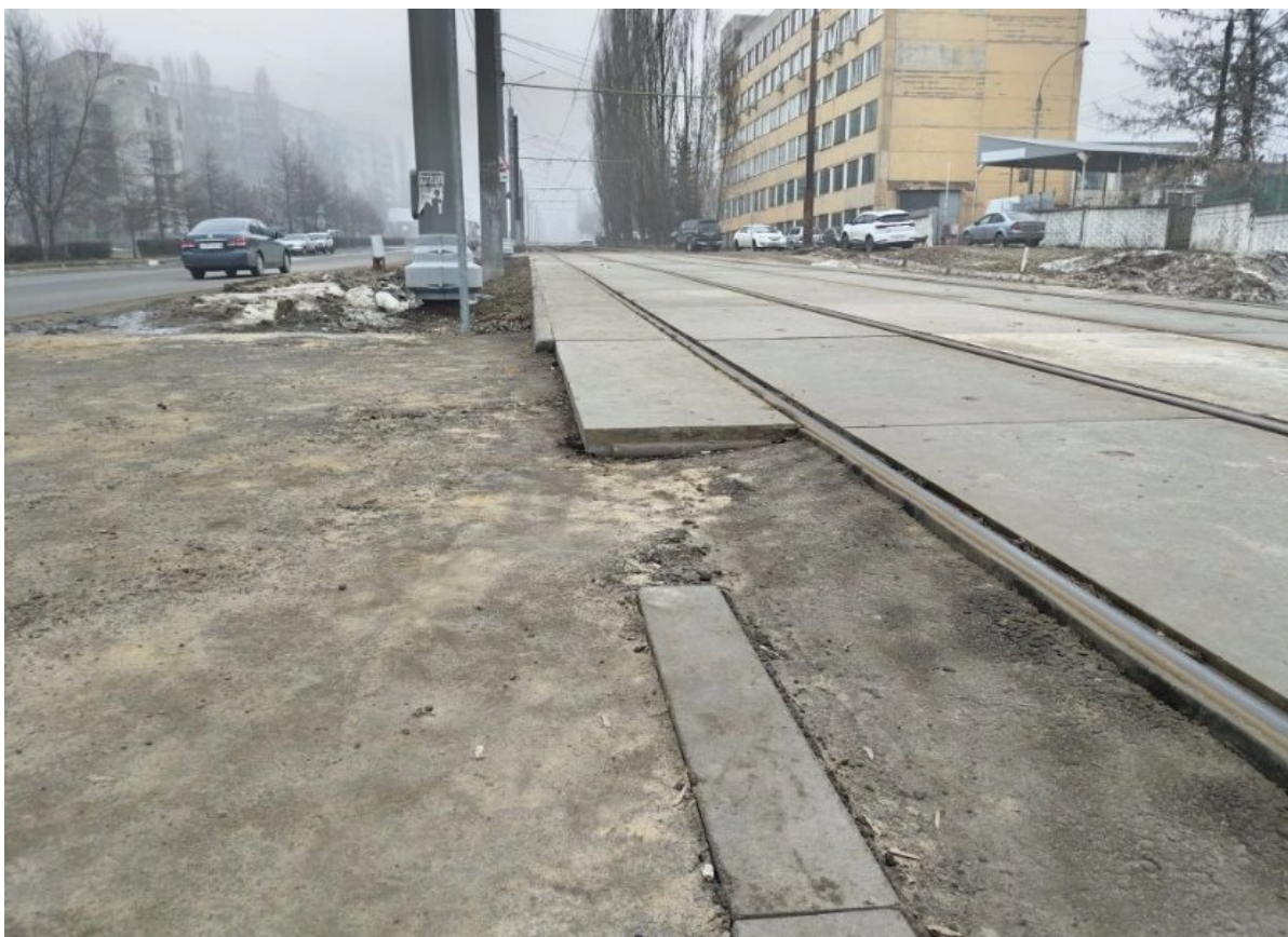
Рис. 101. Остановочный пункт «Улица Полиграфическая». Отсутствует закрепление краевой плиты.
