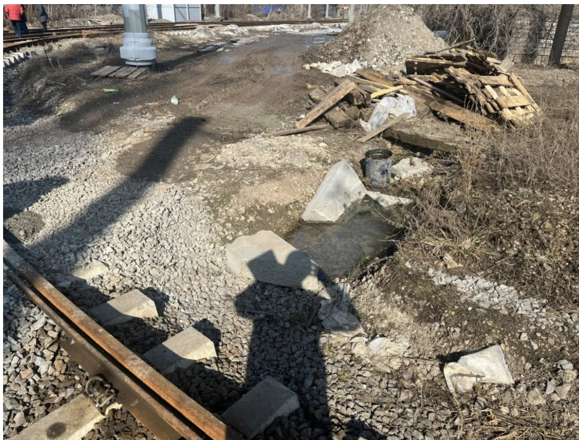
Рис. 110. Выезд из трамвайного депо подтопление балластного слоя трамвайных путей.
