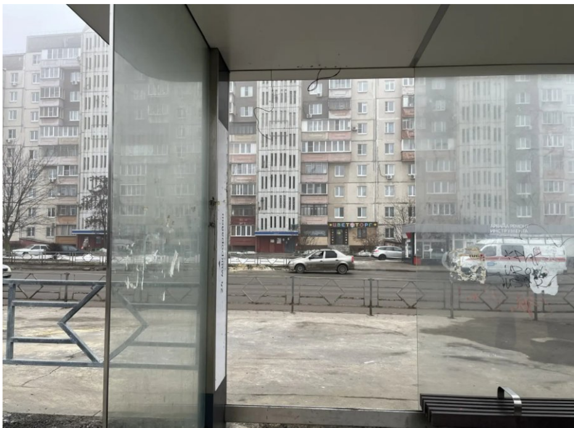
Рис. 83. Остановочный пункт «24 микрорайон». Отсутствует стеклянная стенка павильона.
