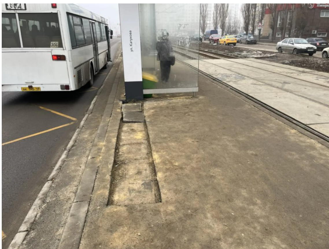
Рис. 59. Остановочный пункт «Улица Катукова». Нарушение целостности асфальтного покрытия.
