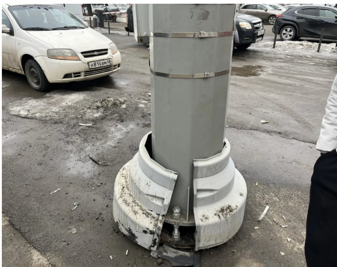
Рис. 42. Улица Краснозаводская в районе проходных ЛТЗ повреждение кожуха опоры контактной сети
