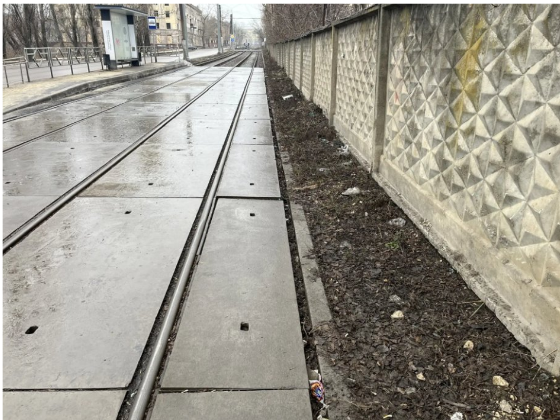
Рис. 26. Неплотное прилегание краевых плит к бордюру на остановочном пункте «3-е Сентября»
