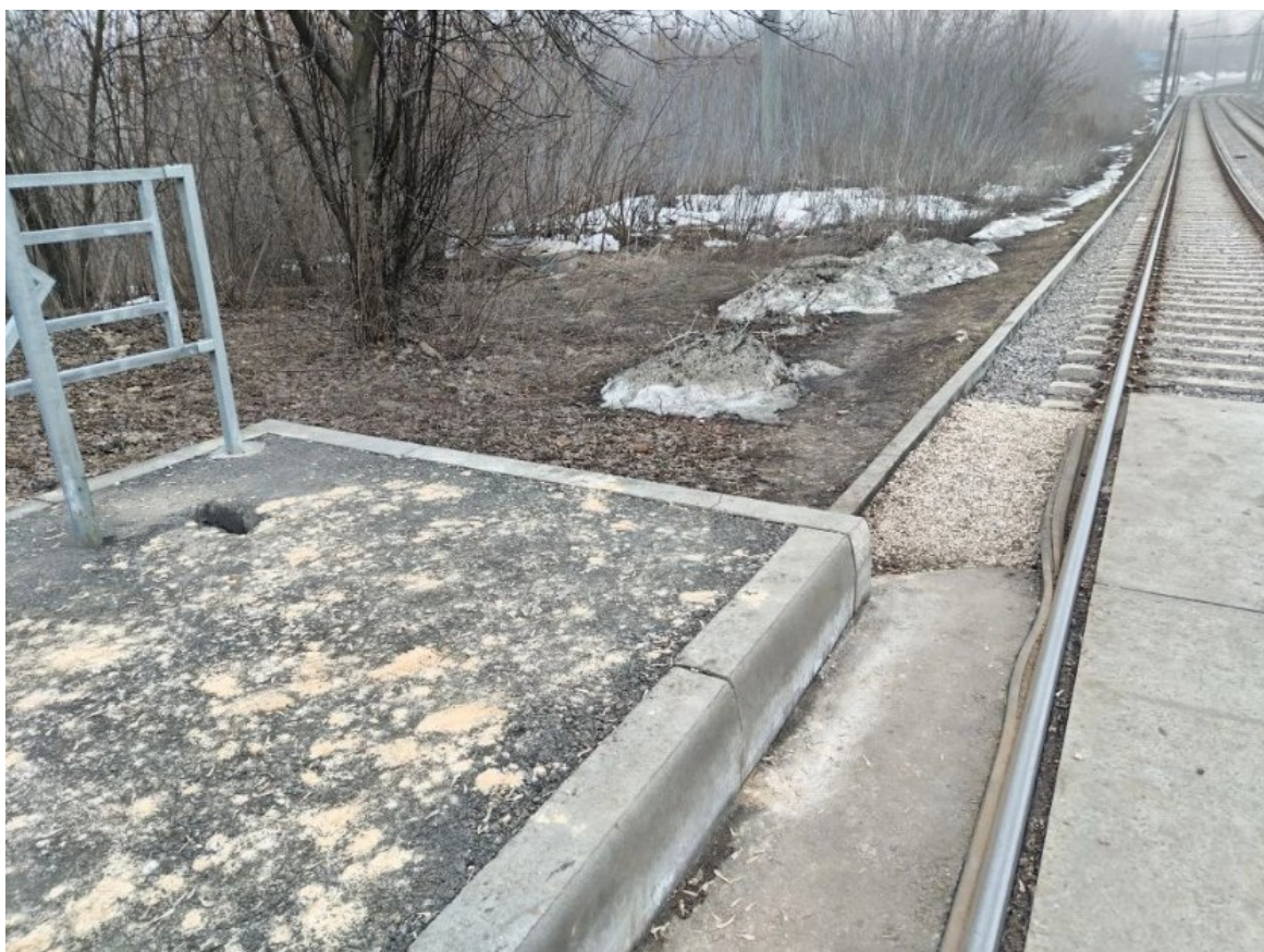
Рис. 98. Остановочный пункт «Улица Полиграфическая». Повреждение и частичное отсутствие асфальтового покрытия.
