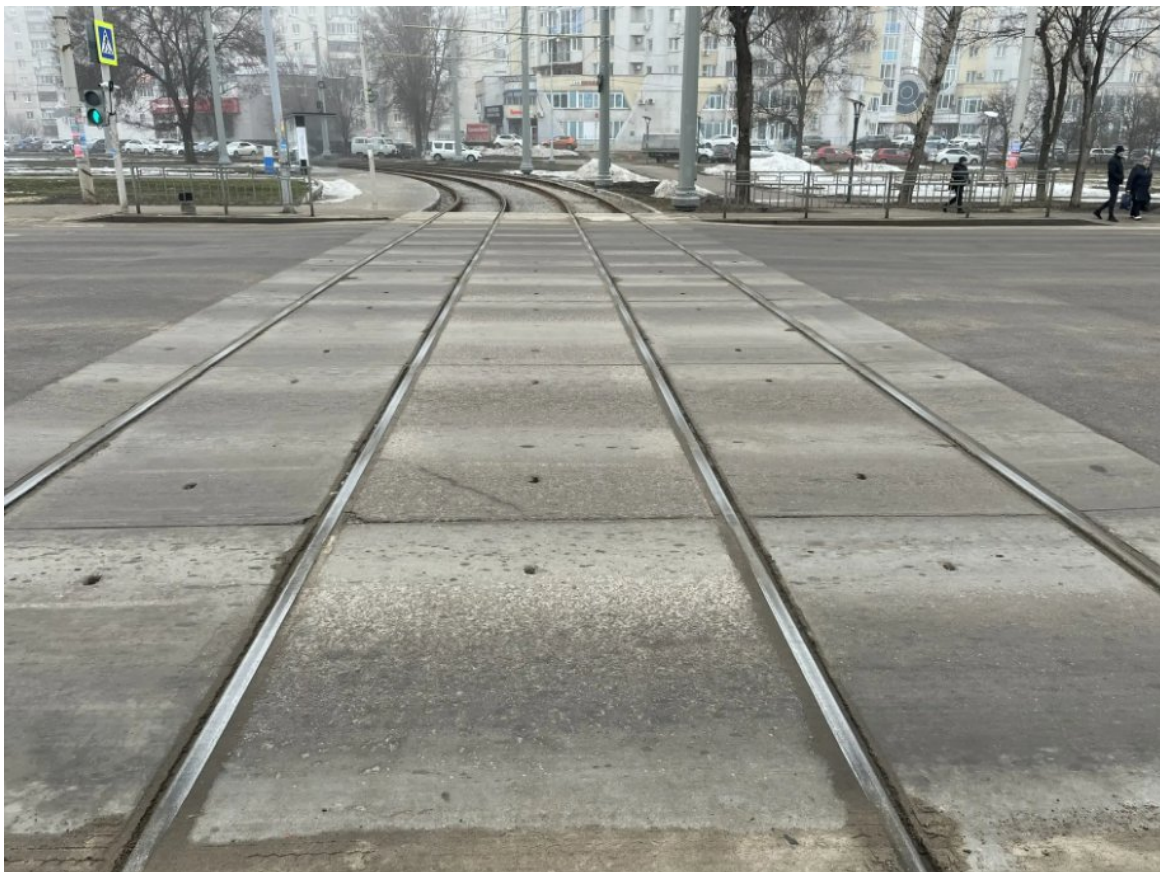
Рис.162. Сетка трещин на плитах, уложенных на пересечении трамвайных путей с проспектом Победы.
