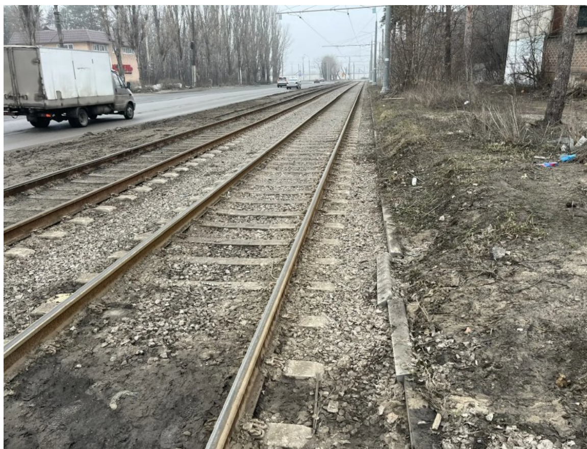
Рис. 44. Улица Краснозаводская повреждение бортового камня.
