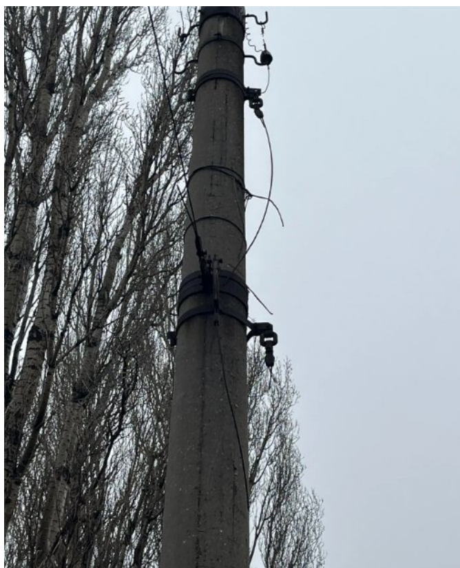
Рис.139. По ул. Metallургов не в полном объеме демонтированы элементы старой контактной сети.
