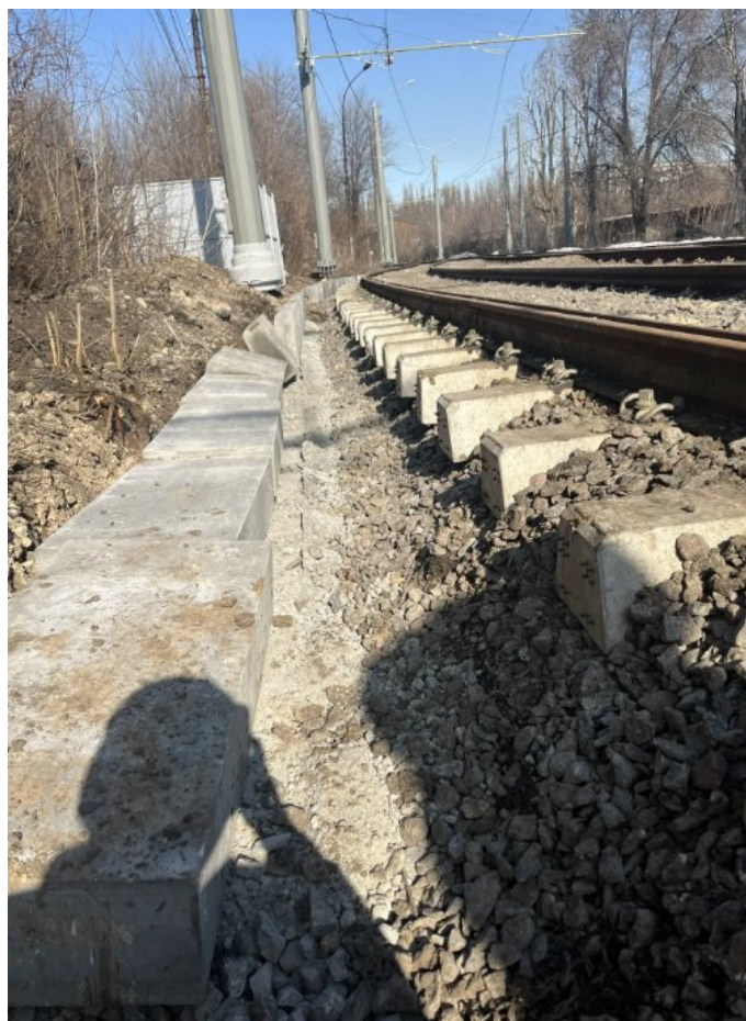
Рис. 111. Трамвайные пути в районе Депо. Отсутствует балластный слой в торцах шпал.
