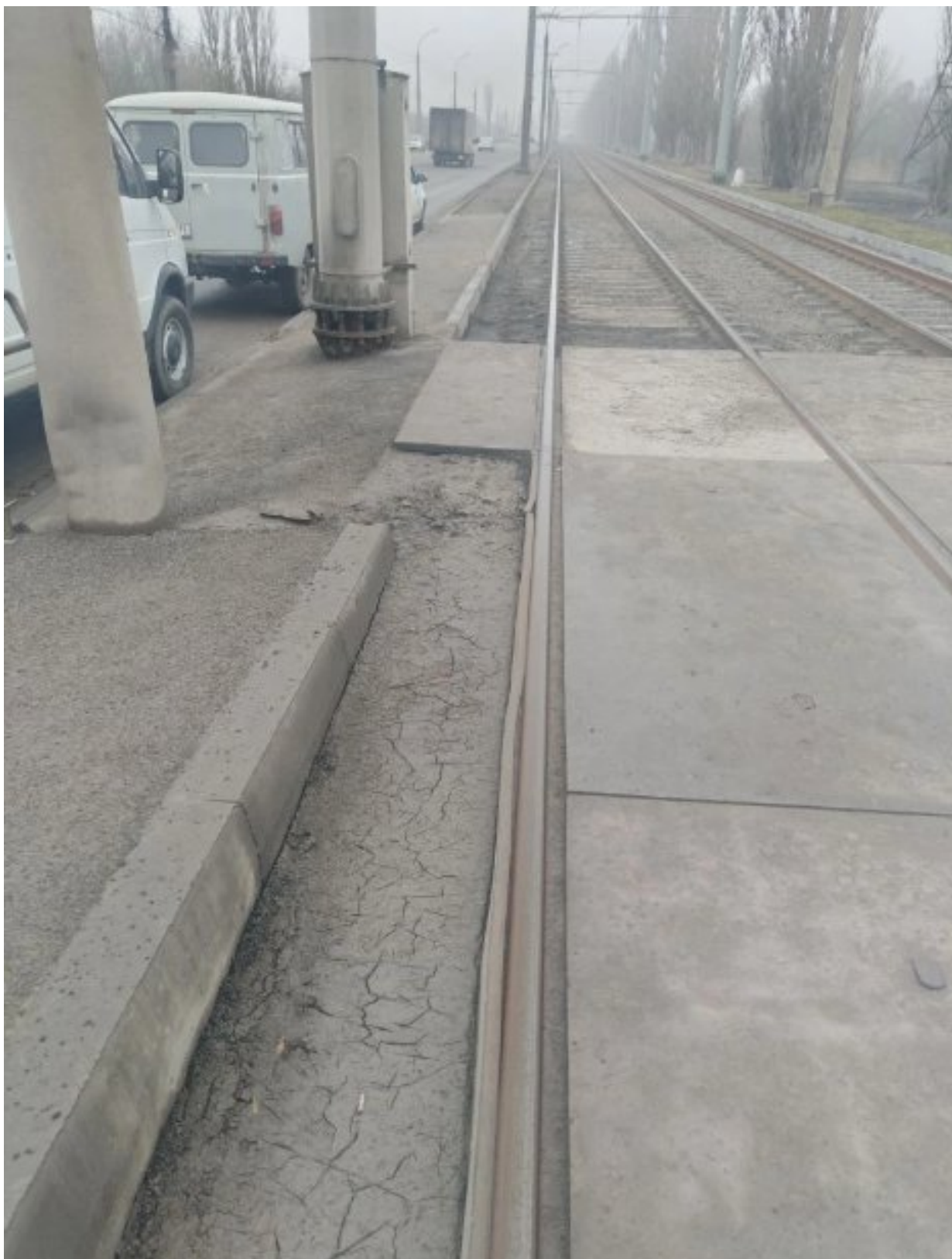
Рис.151. Остановочный пункт «ул. Речная». Асфальтирование между остановочной платформой и трамвайными путями не выполнено, уплотнительная резинка не плотно прилегает к рельсу, балластный слой пути загрязнён.
