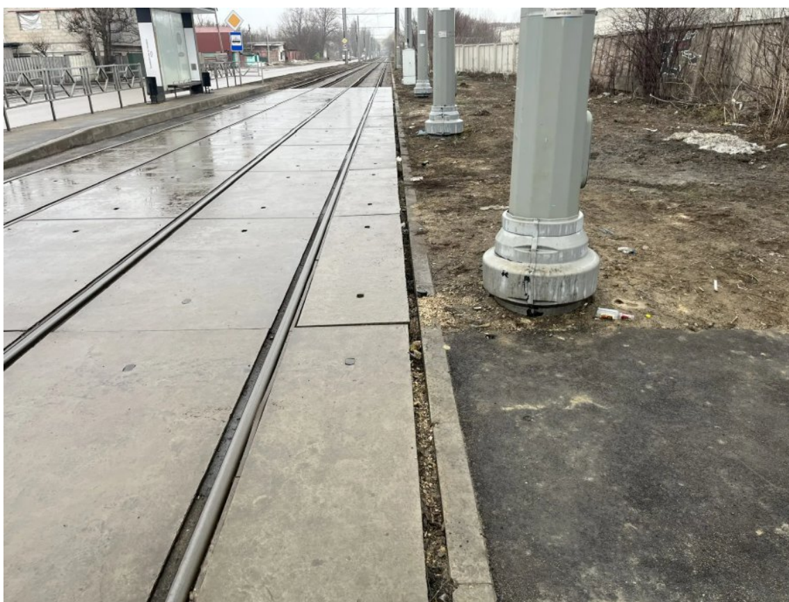
Рис. 22. Остановочный пункт «РСУ» неплотное прилегание плит к бортовому камню.
