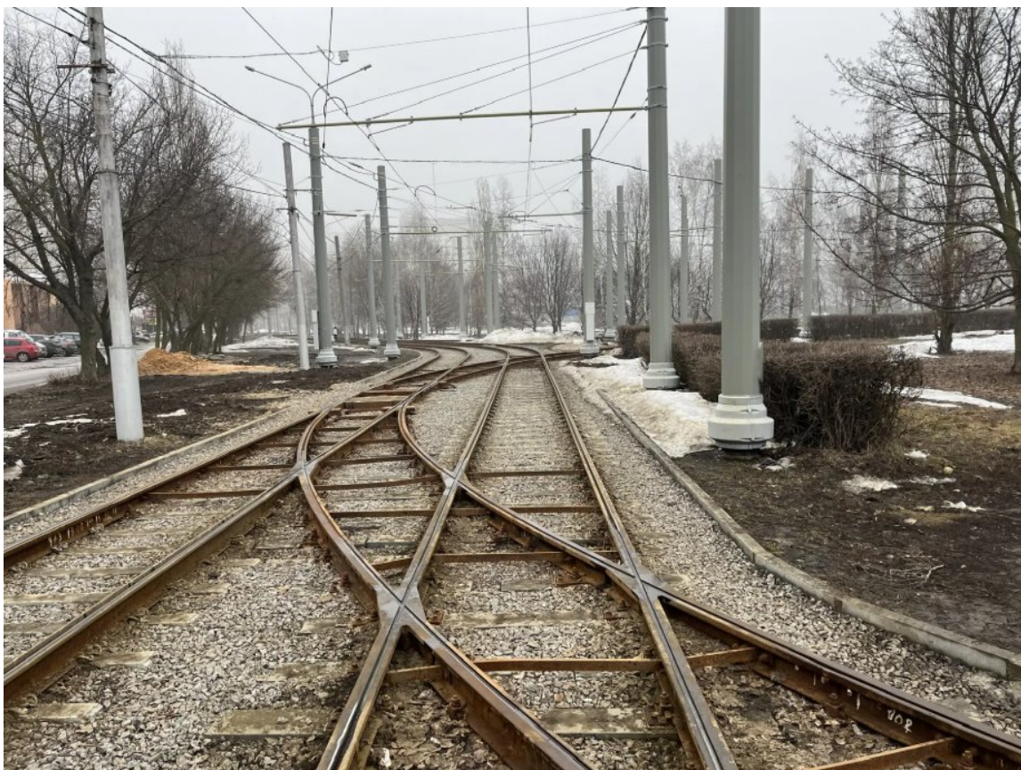
Рис. 54. Разворотный круг на 21 микрорайоне. Стрелочный перевод не работает в автоматическом режиме.
