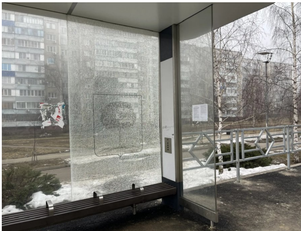
Рис. 80. Стеклопанель остановочного павильона «Березовая Аллея» в сетке трещин.
