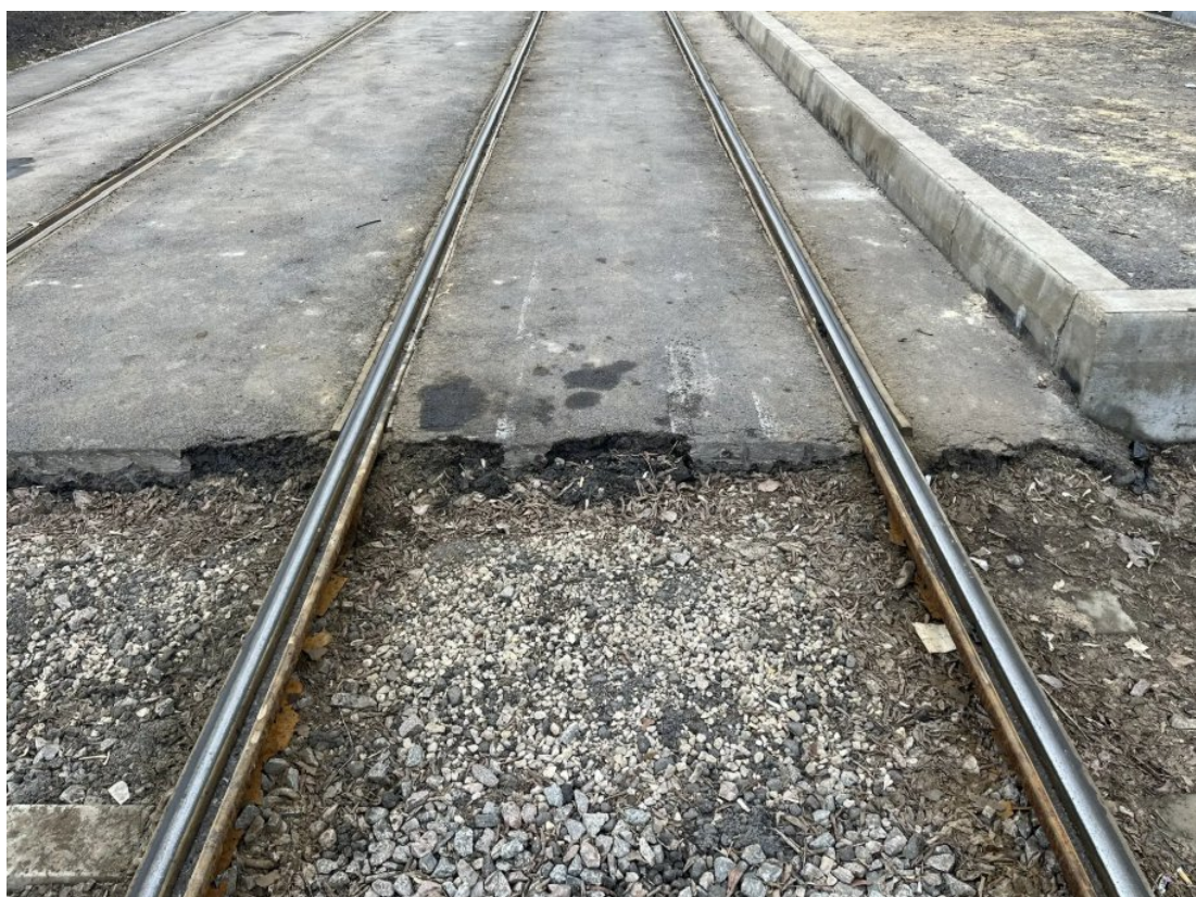
Рис. 57. Разрушение кромки асфальтного покрытия на остановочном пункте «21 микрорайон»
