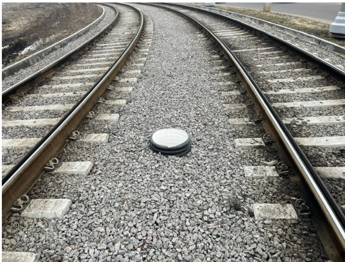
Рис. 88. Парк Победы. Отсутствует люк дренажного колодца.
