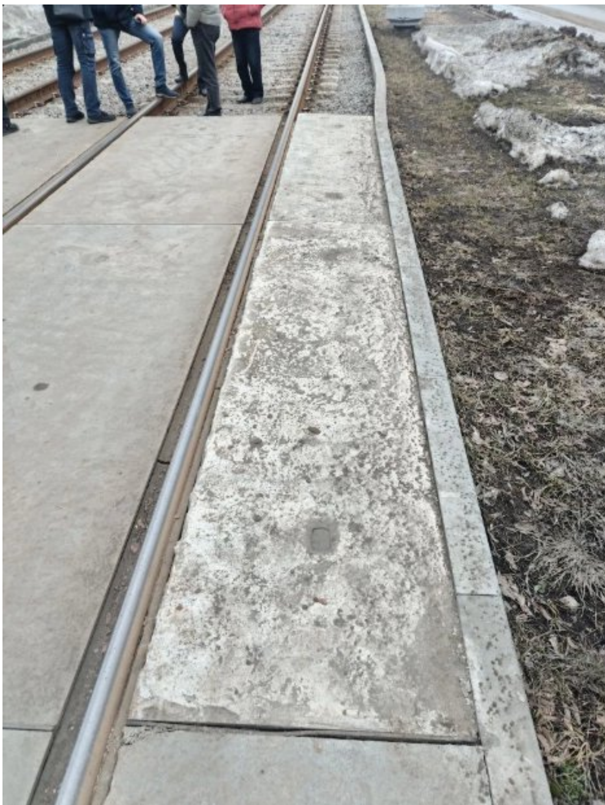
Рис. 95. ЖБ плиты визуально отличаются друг от друга, при последующих проверках потребуется сравнение марок укладываемых плит, сертификаты на плиты, договоры поставки, сравнение с ПСД.
