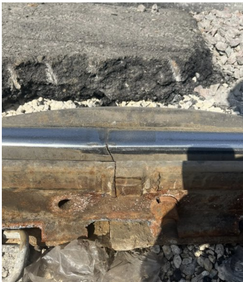
Рис. 13. Излом сварного стыка рельсов в районе разворотной петли ул. Чехова.
