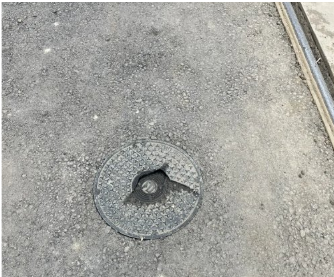
Рис. 84. Остановочный пункт «24 микрорайон». Поврежден люк дренажного колодца.
