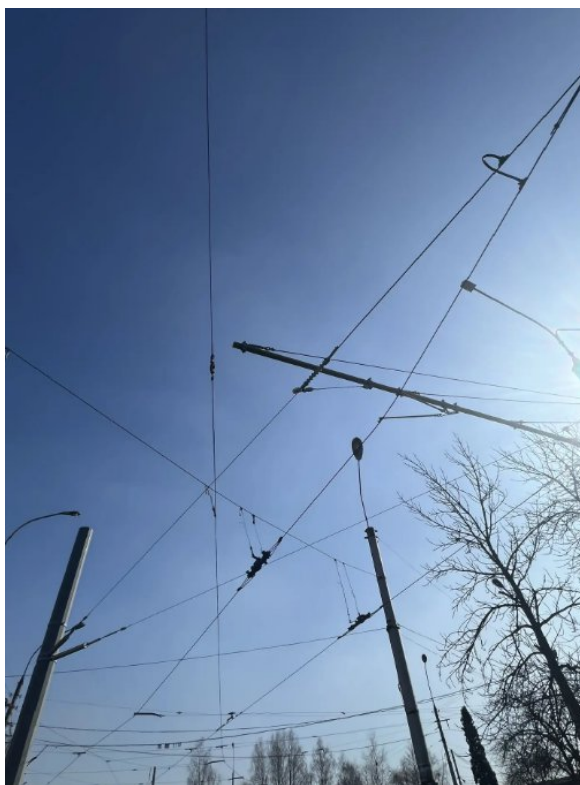
Рис. 109. Въезд в депо. Не работает грузовая компенсация контактной сети (концевой клиновой зажим на тросе затянут в ролик).
