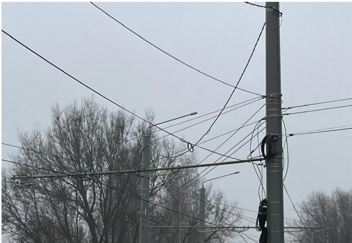
Рис.164. Пересечение с проспектом Победы. Высота подвеса контактного провода относительно кронштейна визуально не соответствует СП 98.13330.2018.
