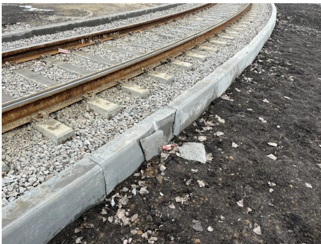
Рис.161. Остановочный пункт «Памятник Танкистам». Повреждение бордюрного камня.
