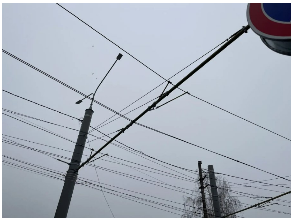
Рис. 104. Остановочный пункт «Полиграфический комплекс». Высота подвеса контактного провода относительно кронштейна визуально не соответствует СП 98.13330.2018.
