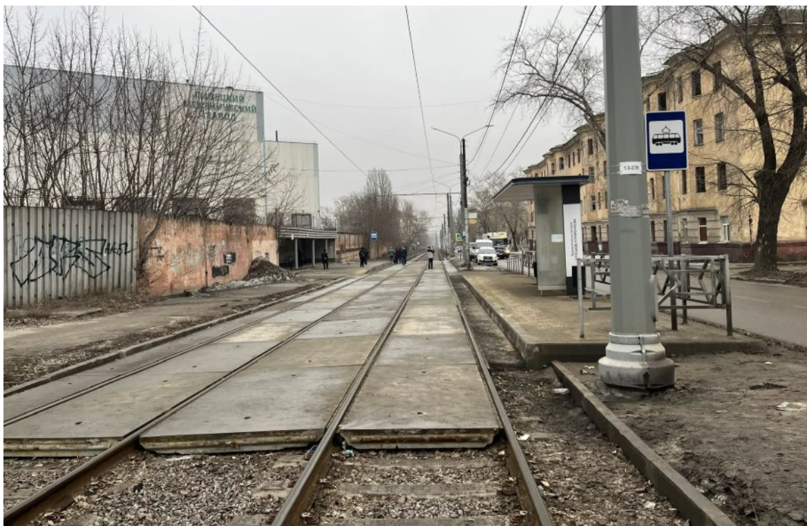
Рис. 27. Текущее состояние остановочного пункта «Площадь Клименкова».
