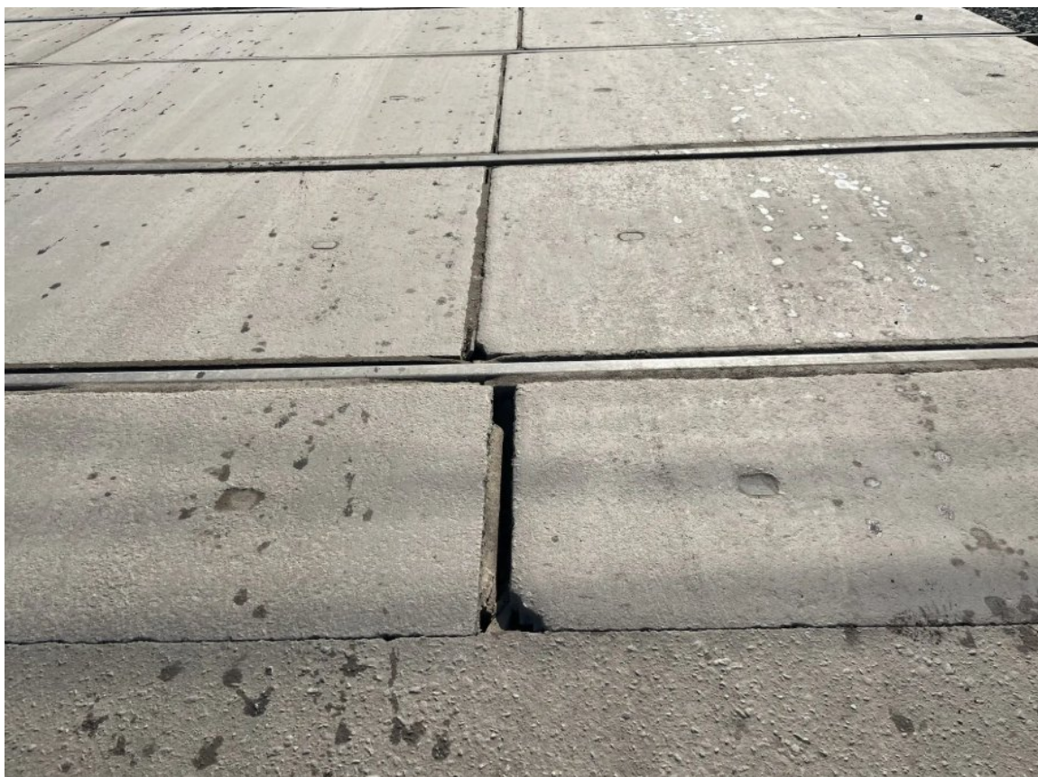
Рис. 64. Неплотное прилегание железобетонных плит на переезде через трамвайные пути по ул. Меркулова.
