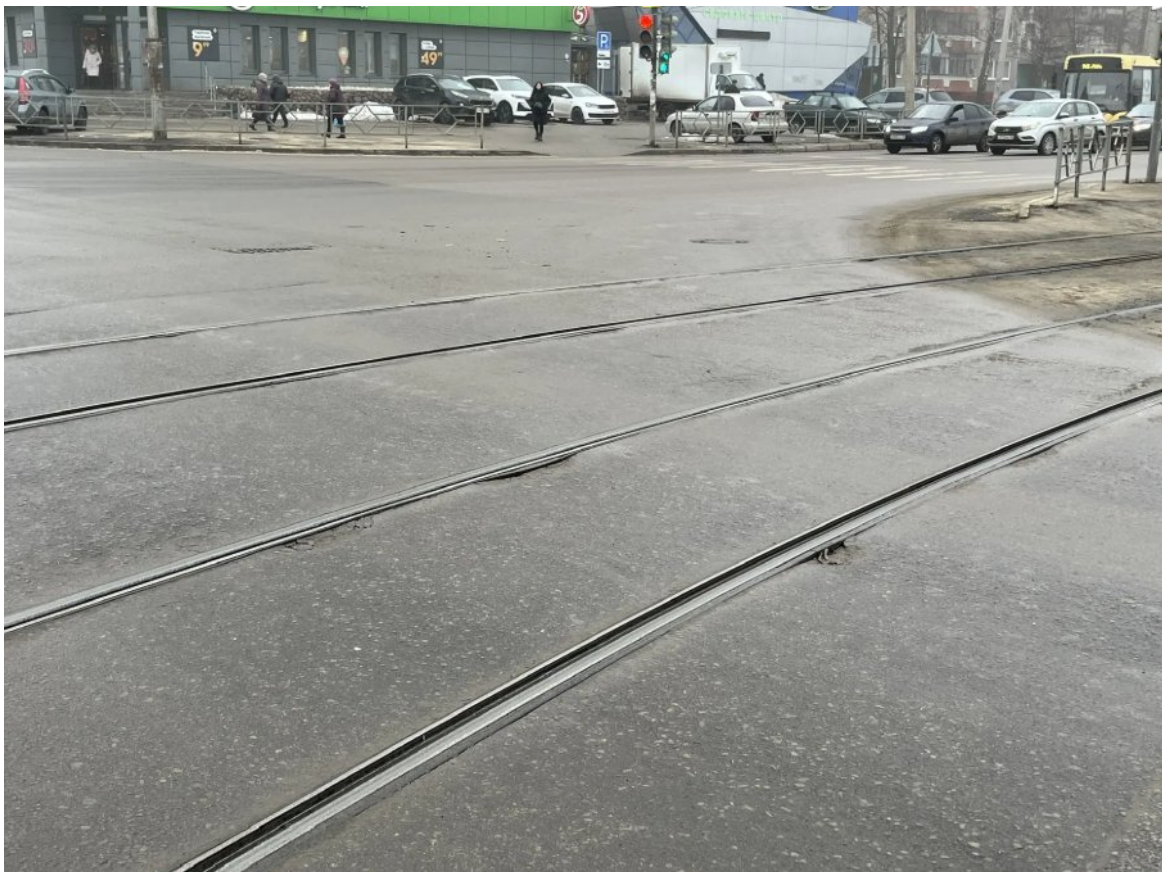
Рис. 66. Просадка дорожного покрытия в районе пересечения ул. Меркулова с пр. имени 60-летия СССР.
