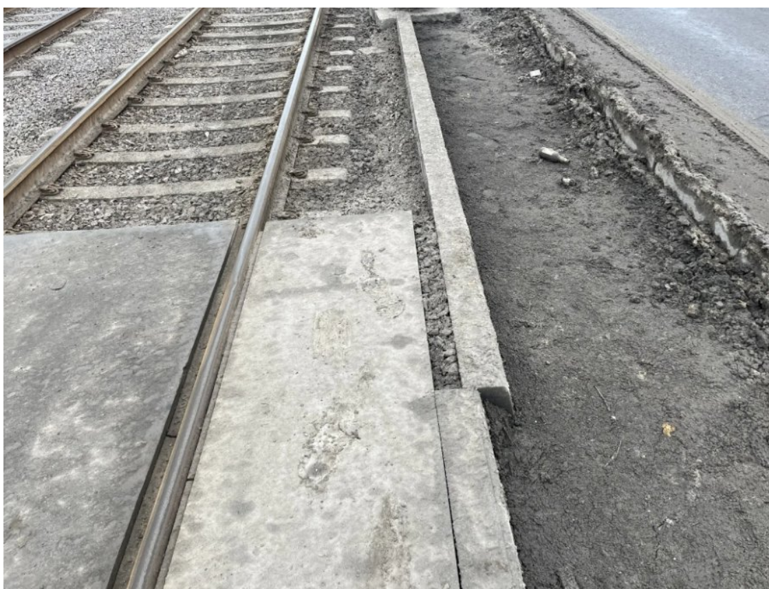
Рис.148. Остановочный пункт «ул. Речная» примыкание бортового камня выполнено не в соответствии с проектной документацией.
