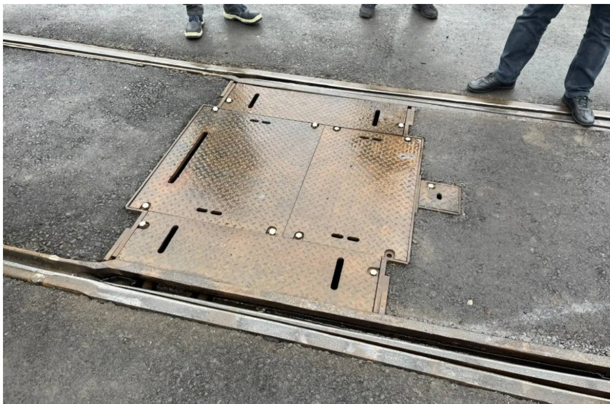
Рис. 20. Улица 3-е Сентября не закреплена крышка стрелочного перевода.
