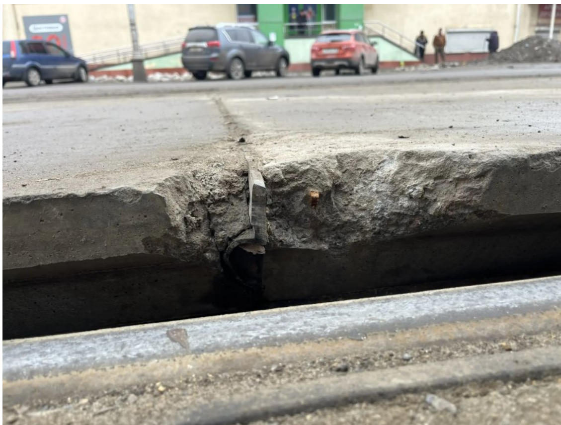
Рис. 40. Остановочный пункт «ЛТЗ» повреждение железобетонной плиты.
