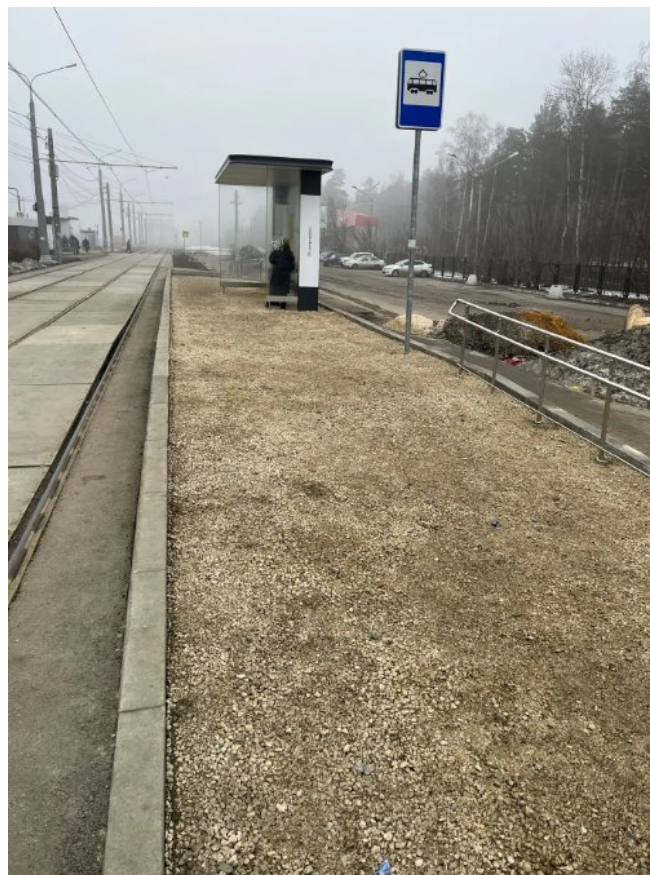
Рис. 82. Остановочный пункт «24 микрорайон». Отсутствует асфальтное покрытие.
