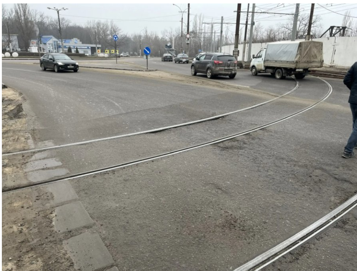
Рис. 48. Переезд в районе пересечения ул. Краснозаводская с ул. Metallургов просадка дорожного покрытия.
