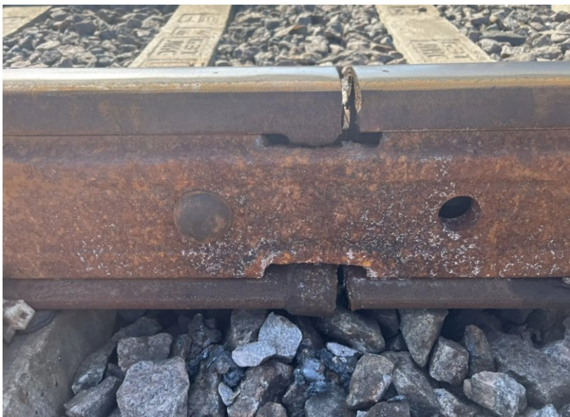
Рис. 87. Излом сварного стыка рельсов в районе остановочного пункта «24 микрорайон».
