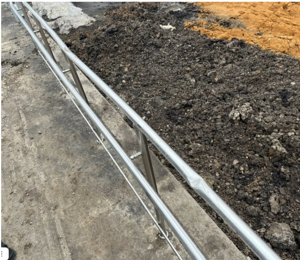
Рис.156. Остановочный пункт «Село Сырское». Пешеходное ограждение повреждено сетевой организацией.
