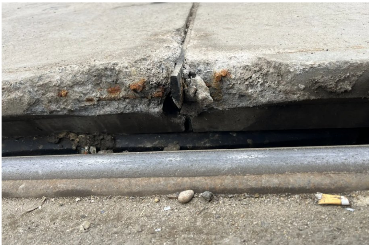
Рис. 79. Повреждение железобетонных плит в районе остановочного пункта «Березовая аллея».
