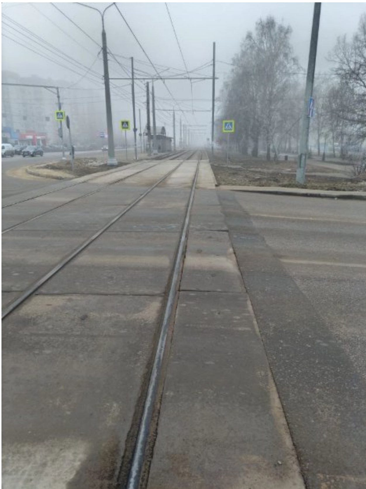
Рис. 74. Смещение краевой плиты на пересечении с ул. Стаханова.
