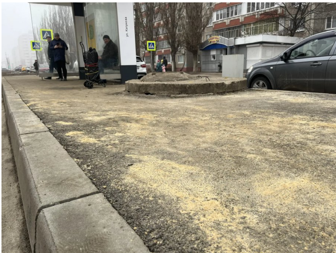
Рис. 62. Просадка асфальтного покрытия остановочной платформы на остановочном пункте «Улица Катукова».
