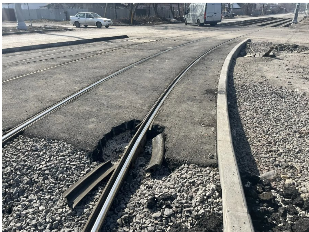
Рис. 14. Разворотная петля ул. Чехова нарушение асфальтного покрытия вследствие проведения ремонтных работ стыка рельсов.
