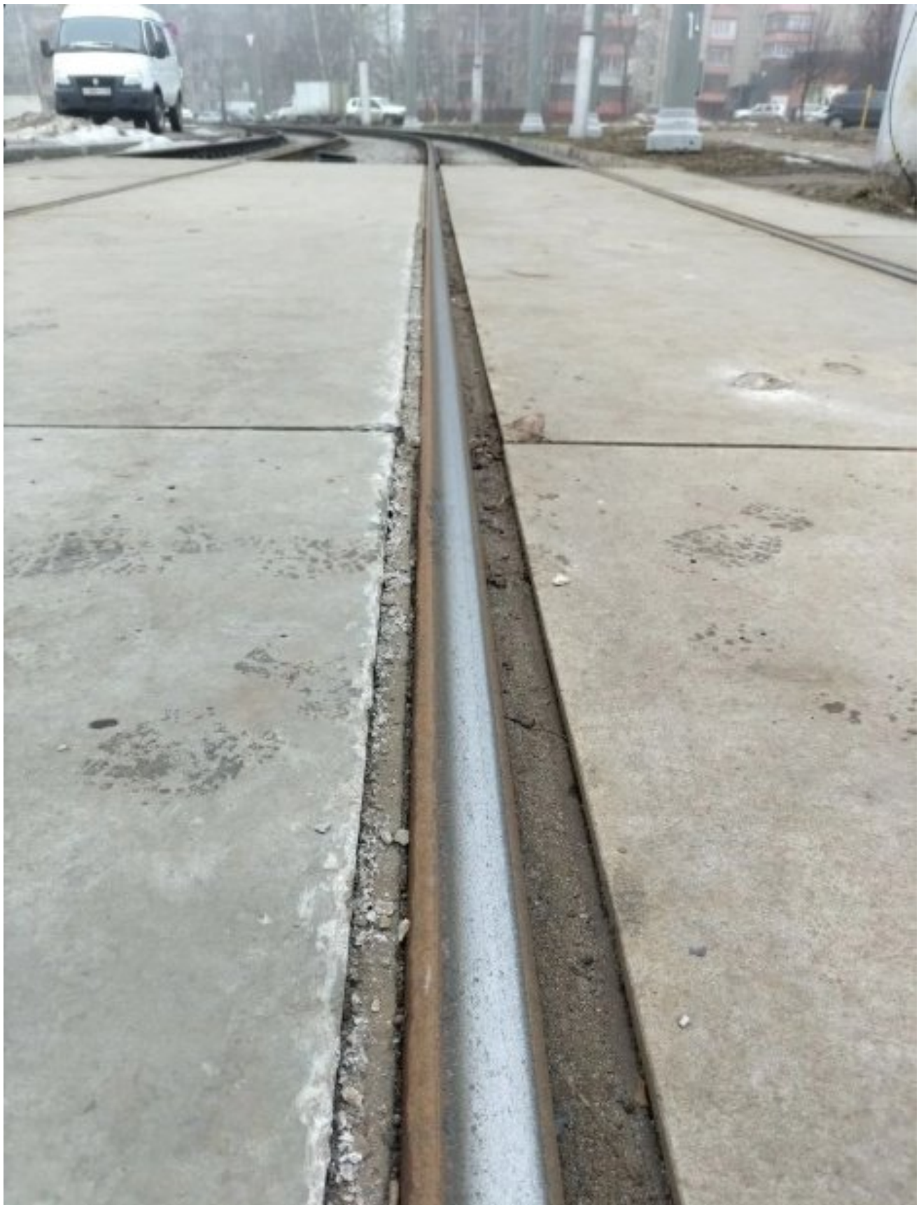
Рис. 105. Остановочный пункт «Полиграфический комплекс». Повреждение межпутевых плит.
