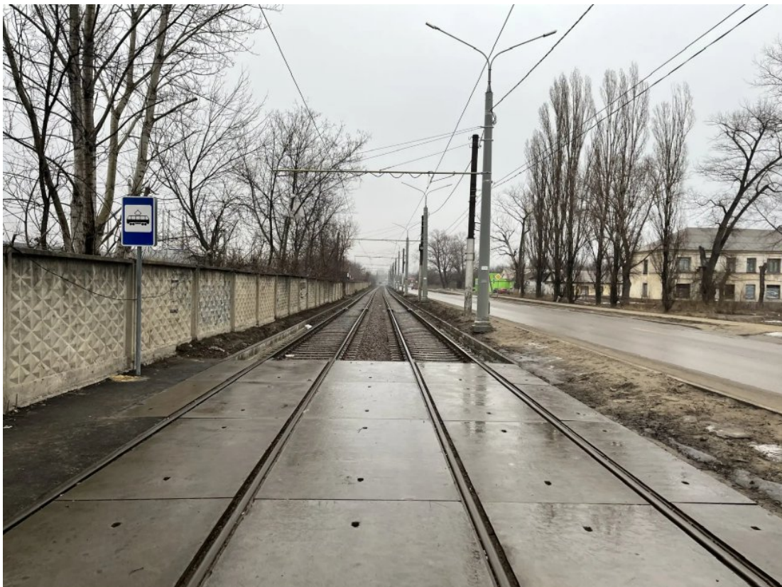
Рис. 25. Текущее состояние остановочного пункта «3-е Сентября» путь в центр, отсутствует остановочный павильон, предусмотренный изначальной проектной документацией.
