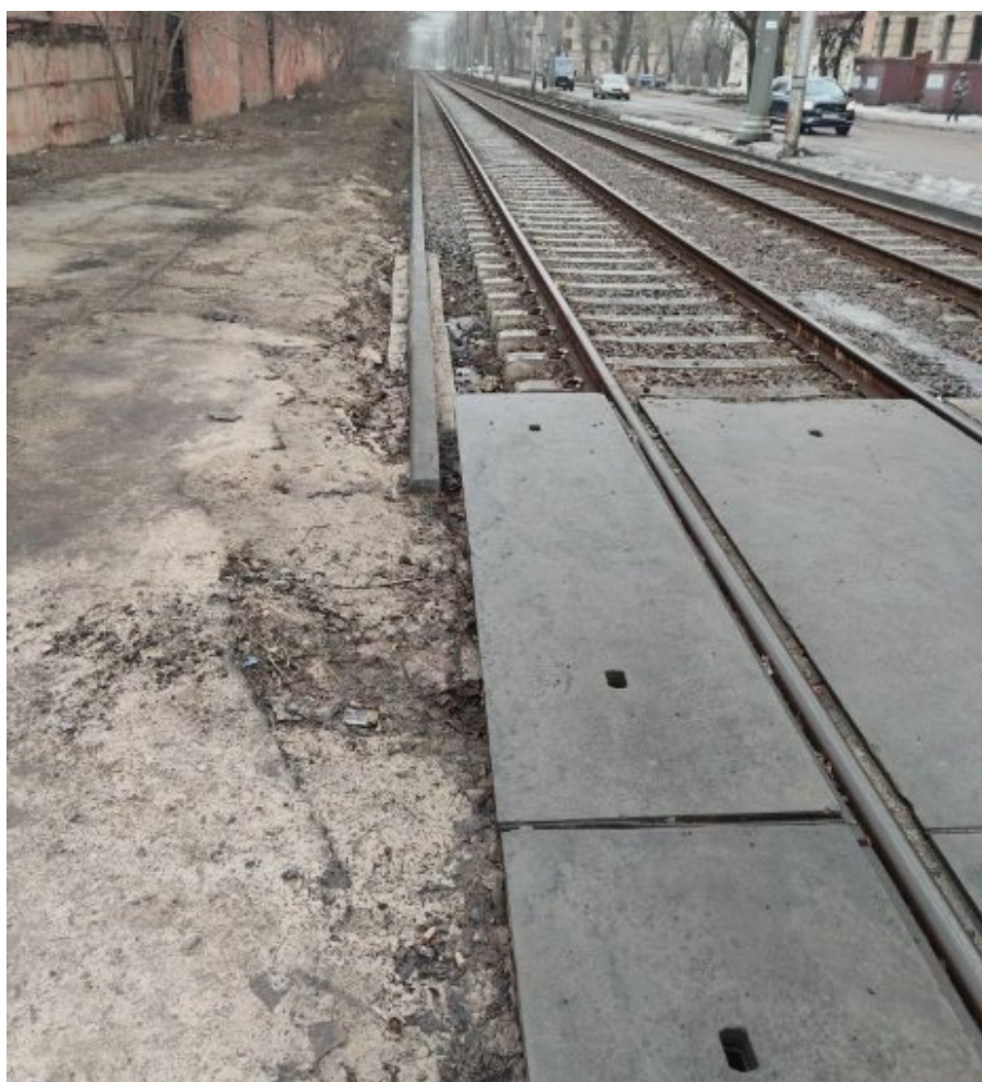
Рис. 28. Текущее состояние остановочного пункта «Площадь Клименкова».
