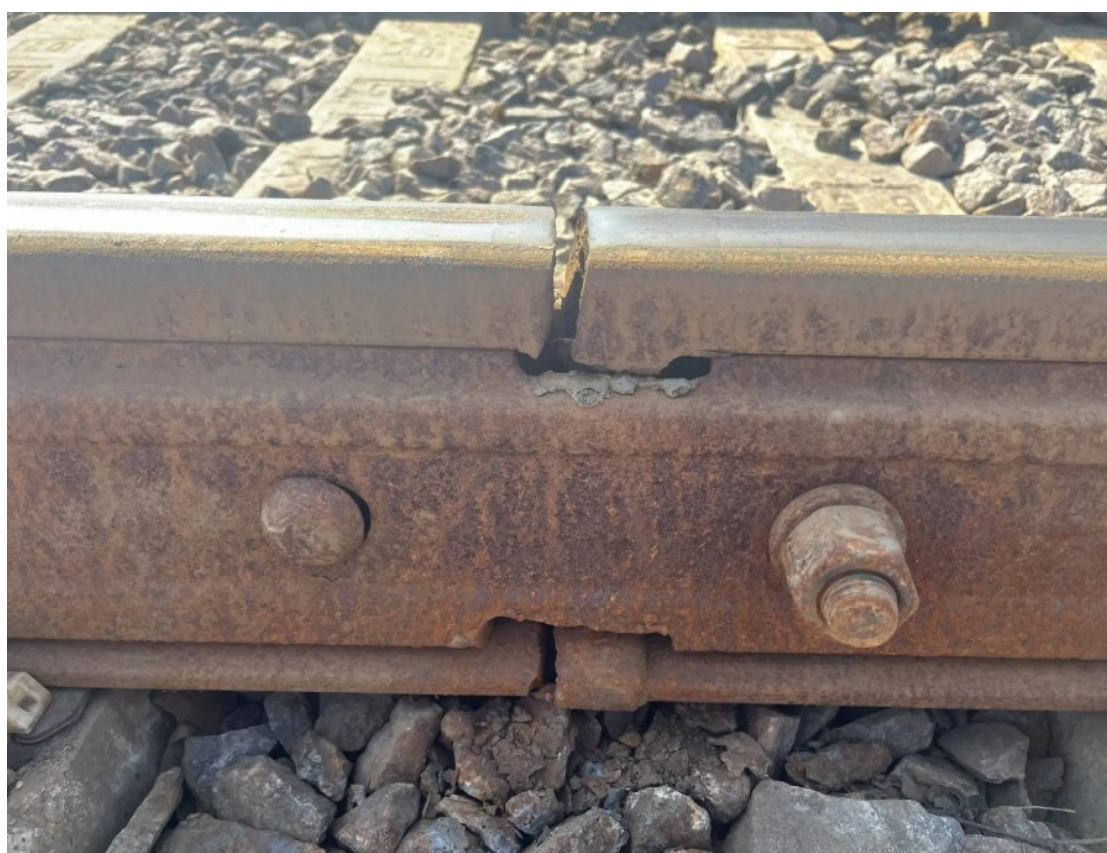
Рис. 86. Излом сварного стыка рельсов в районе остановочного пункта «24 микрорайон».
