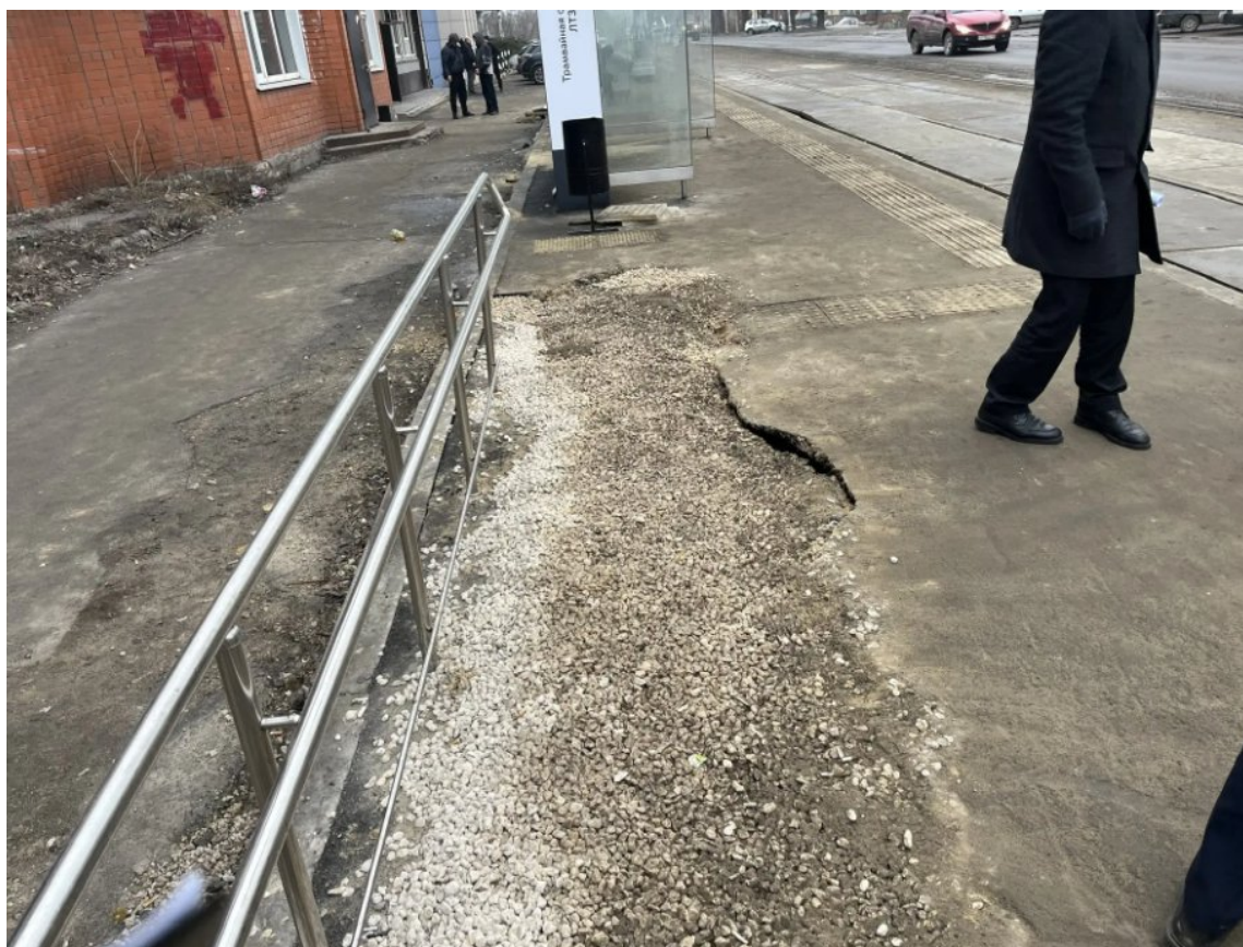
Рис. 36. Остановочный пункт «ЛТЗ». Повреждение асфальтного покрытия посадочной площадки при производстве работ сетевой организацией.
